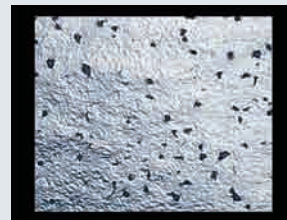
全体にムラなく剥離が見られる
